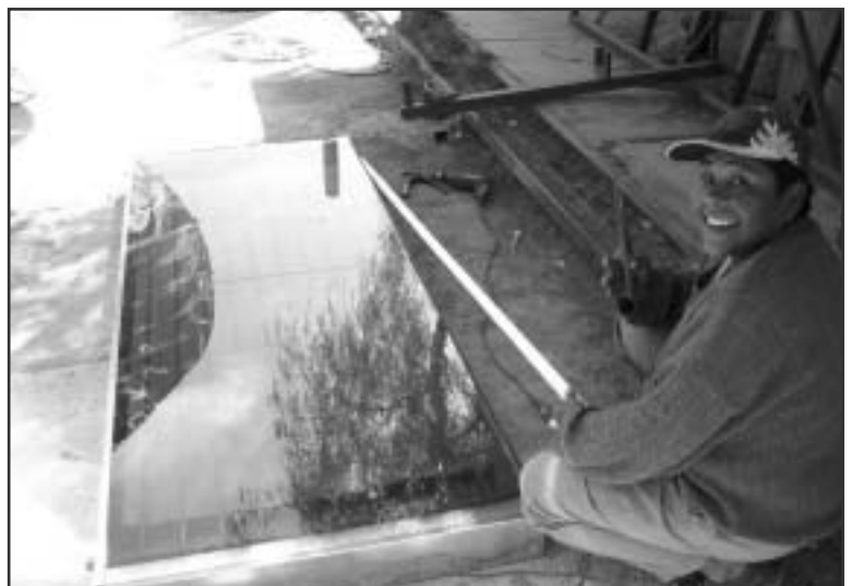
Warmwasserkollektoren gebaut von der Kooperative PIRCA/Tilcara in Argentinien
